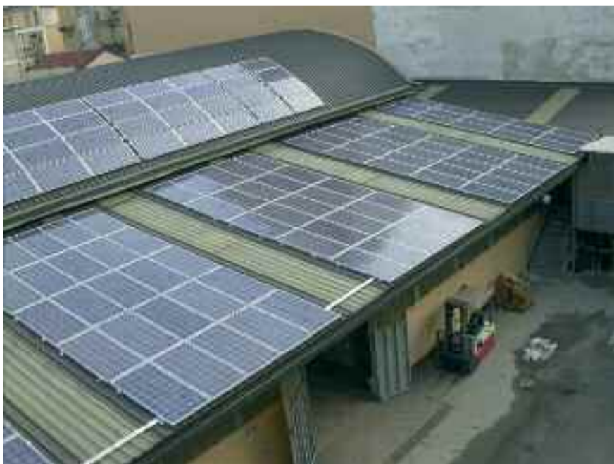
Il 26 Gennaio 2009 è entrato in produzione l'impianto fotovoltaico montato sul tetto del capannone 2 della nostra società. È stato ultimato con 218 pannelli fotovoltaici, per una superficie complessiva di 305 mq e una potenza di poco superiore a 40 kWp. Questo progetto pilota per la zona Nord di Milano, che intende produrre energia pulita e rinnovabile, consente una totale indipendenza energetica e un tornaconto interessante per l'esubero che viene venduto al Gestore dei Servizi Elettrici.
