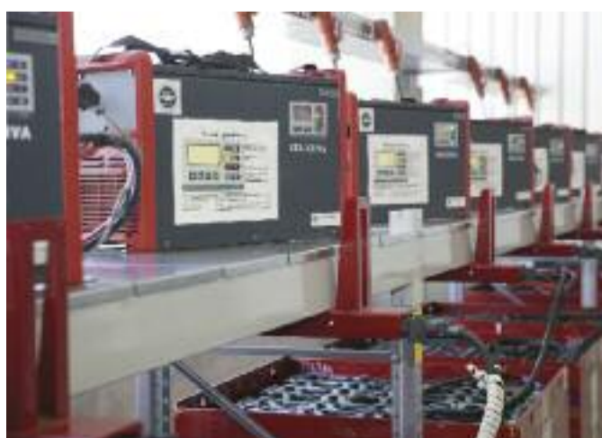
Per la carica delle batterie da trazione AUDI punta sui caricabatteria Fronius Selectiva, nello sviluppo dei quali la casa automobilistica è stata coinvolta sin dall'inizio
